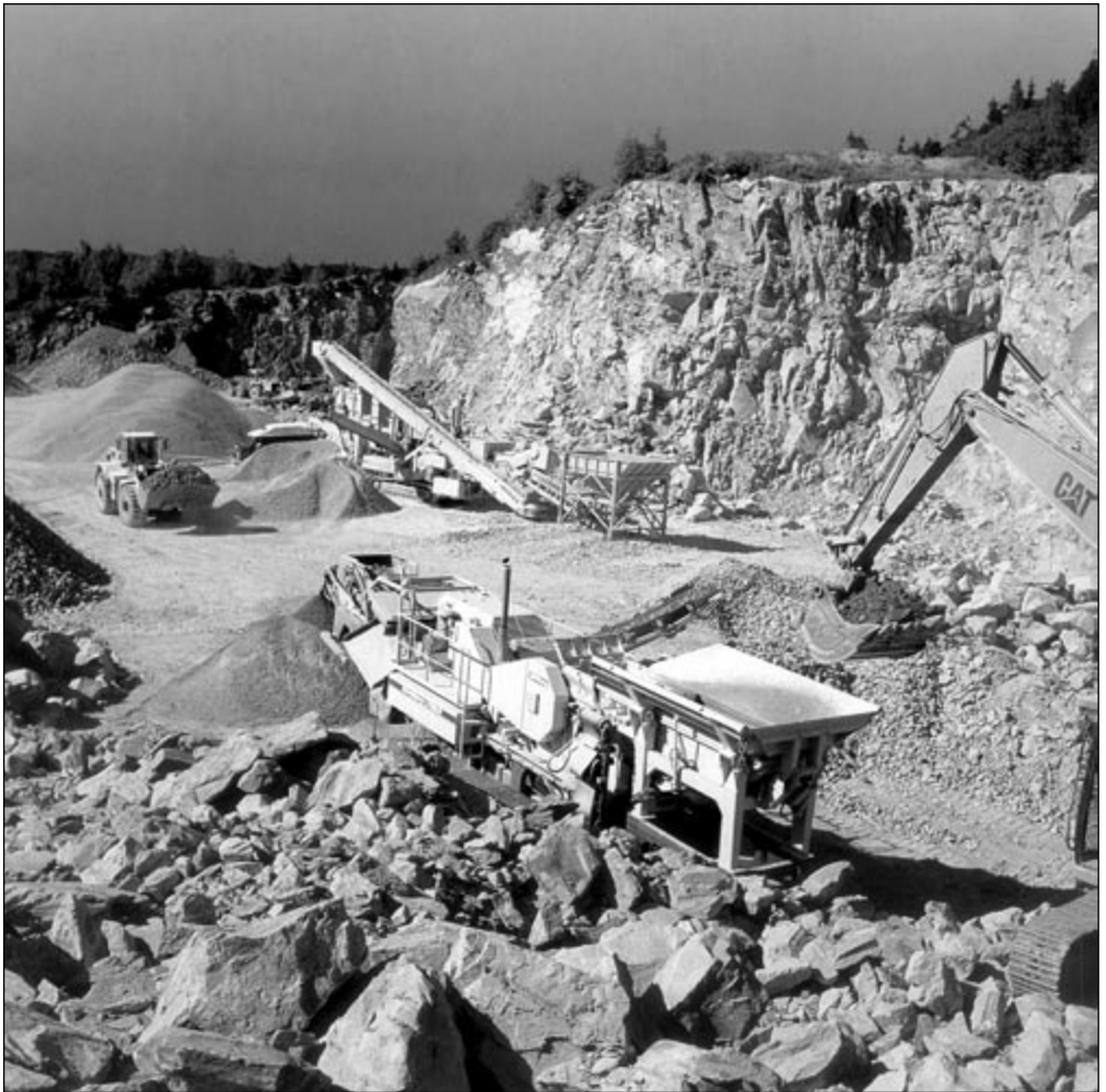
Rys. 27. Układ przeróbczy samojezdny na poziomie eksploatacyjnym
