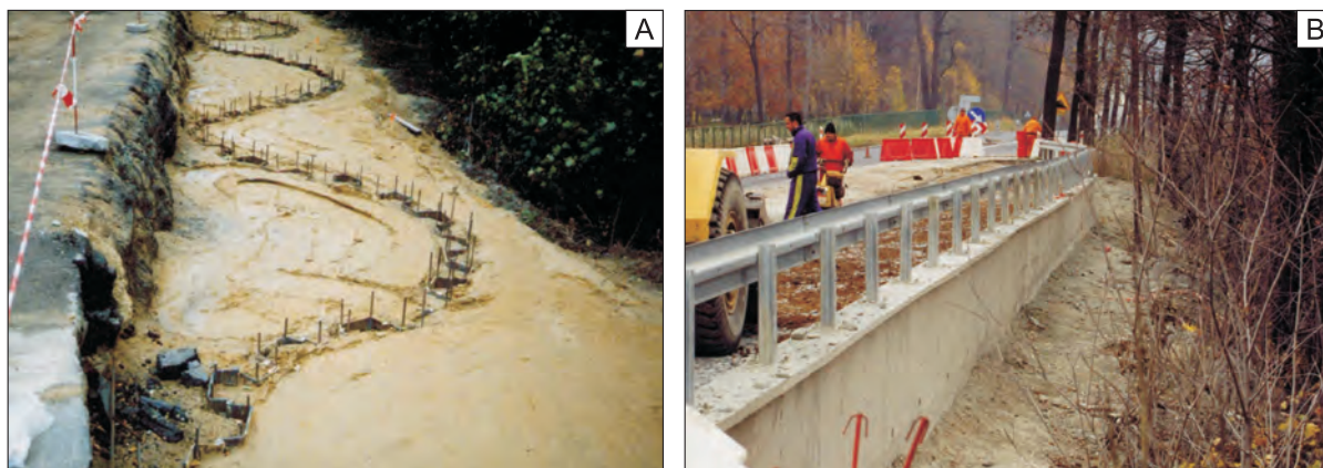
Fig. 4. Falista przypora wbijana służąca stabilizacji osuwiska i poszerzeniu drogi. A. Falista ścianka szczelna z grodzic. B. Gotowa przypora po wykonaniu umocnienia zbocza
