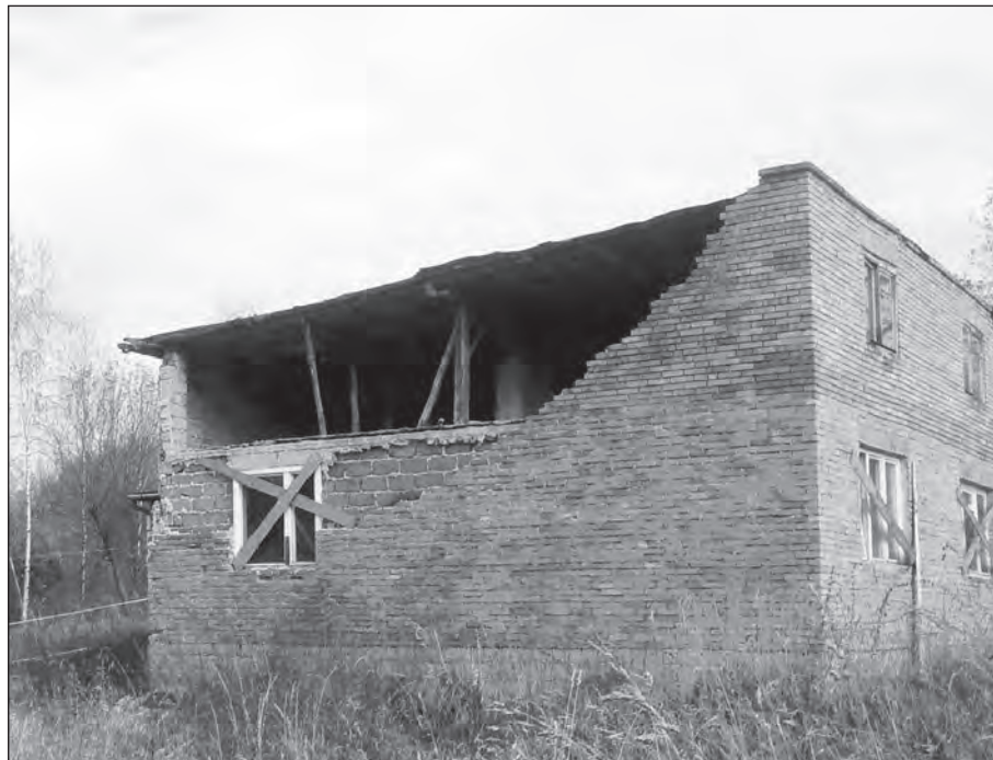
Fig. 1. Katastrofa budowlana będąca wynikiem posadowienia obiektu na terenie osuwiska (Zabawa, powiat wielicki). Uszkodzeniu uległy ławy fundamentowe, ściany i układ konstrukcyjny budynku
