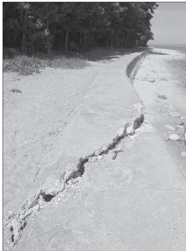
Fig. 1. Rozewie – ochronna opaska betonowa zniszczona przez osuwisko w 2005 r.
